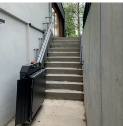
Treppenlift zu den Kellerräumen
